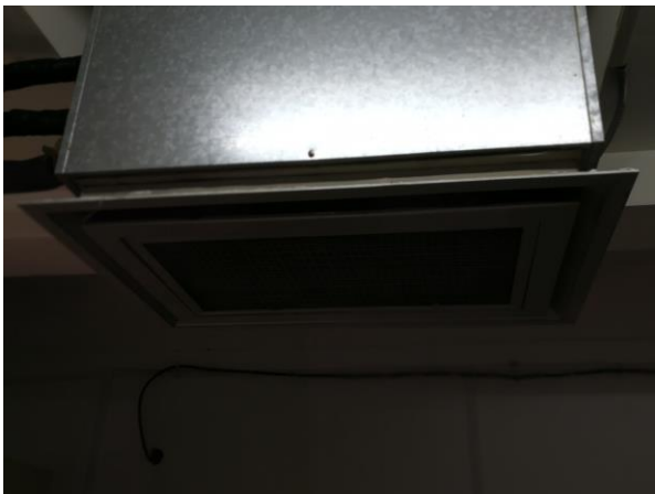
铯源辐照仪室排风口
