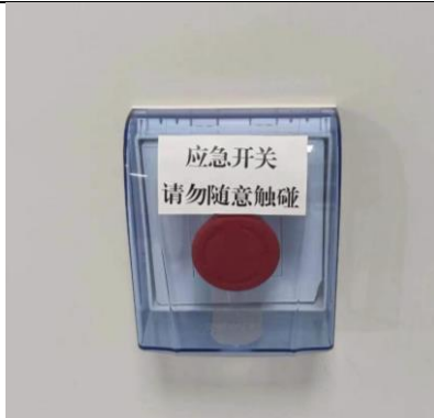
墙壁上的急停按钮
