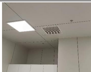
顶板百叶送风口
